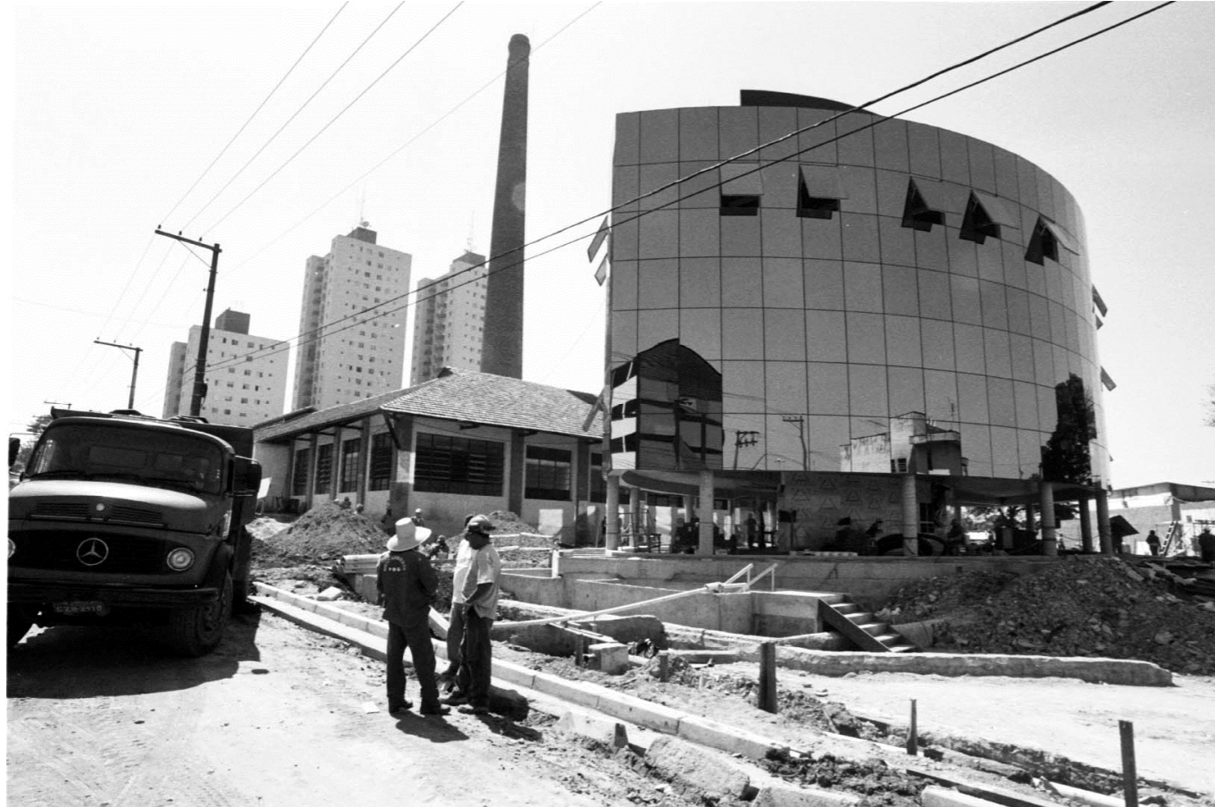
Figura 22. Foto da construção do prédio em elipse. Fonte: Vera Jursys, acervo Arquivo Histórico.
